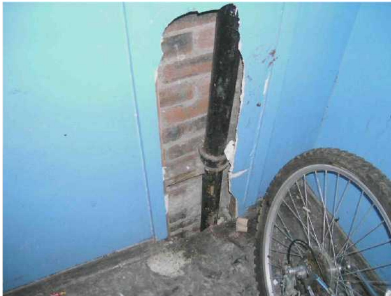
Rysunek 6.4 Azbestowa płyta izolacyjna; należy rozważyć usunięcie azbestu, ponieważ płyta jest w tym miejscu narażona na uszkodzenie
