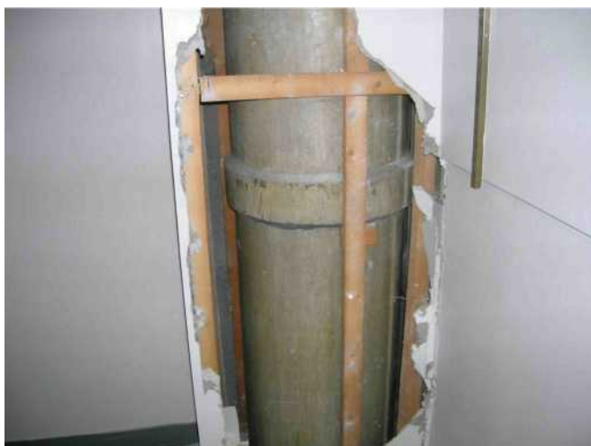
Rysunek. 4.2 Obudowa azbestowej płyty izolacyjnej częściowo usunięta w celu pokazania azbestowo-cementowego kanału dymowego z tyłu
