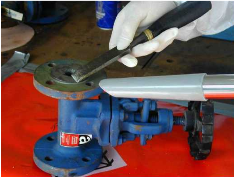
Rysunek 11.6 Wykorzystanie odkurzania jednoczesnego w celu przechwy- cenia kurzu wzniesianego w trakcie oczyszczania zaworu z azbestu
