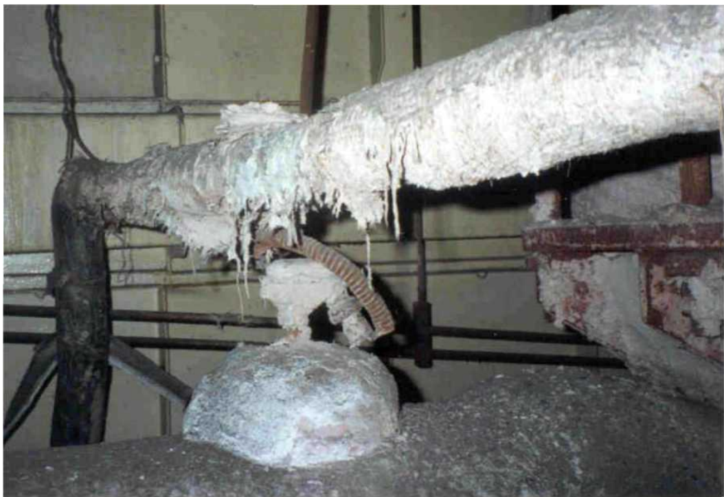
Rysunek 4.8 Izolacja azbestowa na układzie rurociągów parowych
