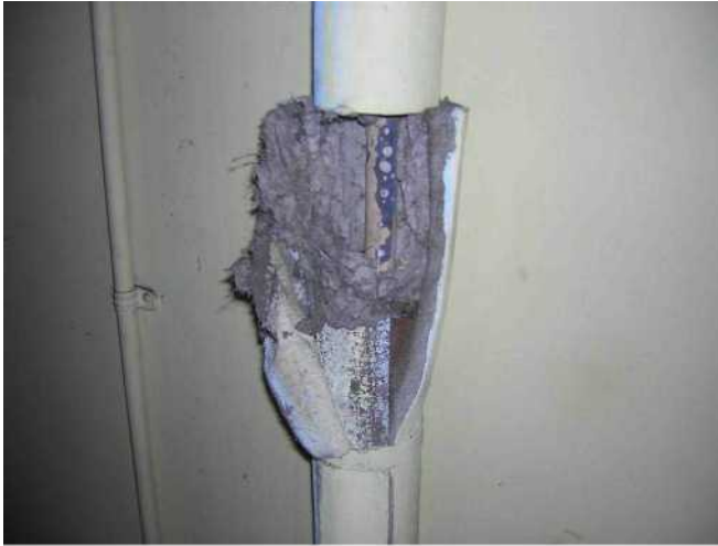
Rysunek 12.7 Azbestowa izolacja rury o widocznych wielu warstwach i penetracja substancji nawilżającej
