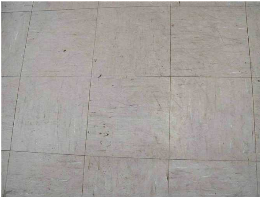
Rysunek 4.6 Azbestowe płyty podłogowe
