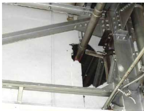
Rysunek 4.3 Ścianka działowa z azbestowej płyty izolacyjnej. Przykład ten ukazuje faktyczne trudności w postawieniu odpowiedniej osłony; widoczne są również powierzchnie, w których w trakcie procesu usuwania może gromadzić się pył azbestowy
