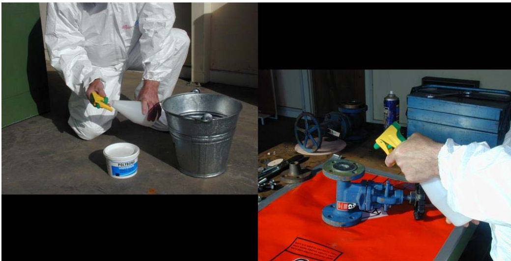
Rysunek 11.4 Zwilżanie uszczelki azbestowej w zaworze
