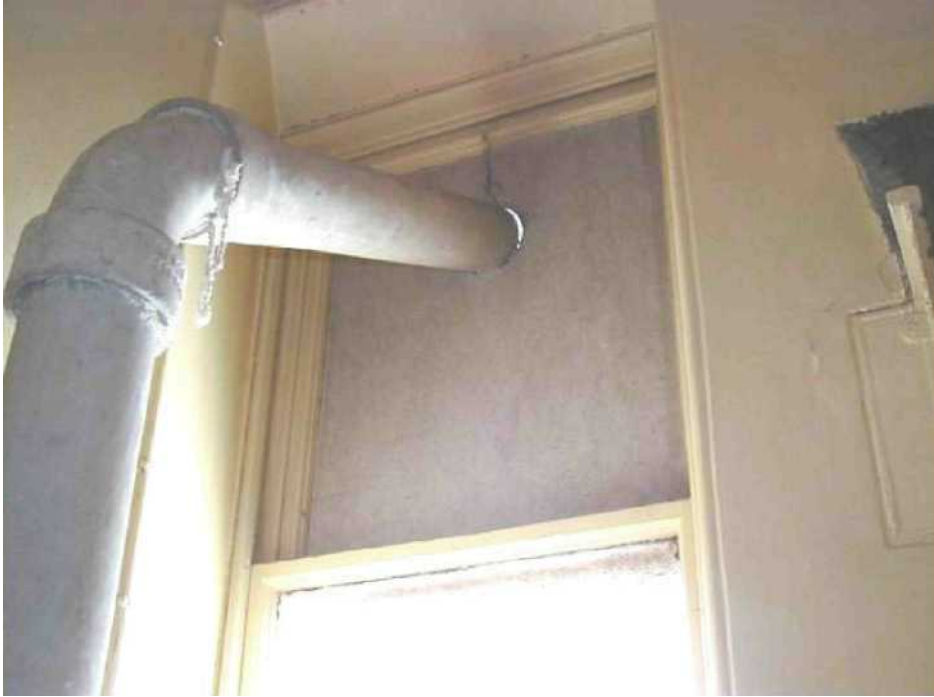
Rysunek 4.5 Azbestowo-cementowy kanał dymowy z uszczelnieniem ze sznura azbestowego przechodzącym przez azbestowy panel wypełniający
