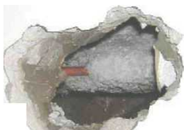
Rysunek 4.4 Przebicie przez ścianę ukazuje azbestową izolację rury
