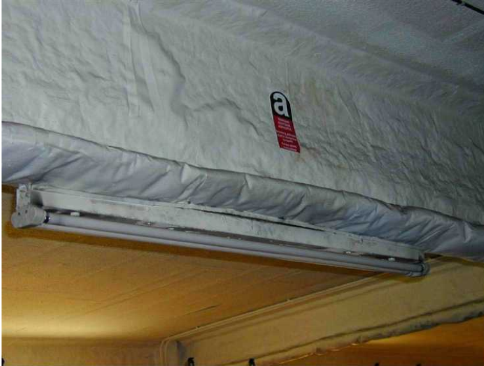
Rysunek 4.11 Izolacja azbestowa na stali konstrukcyjnej
