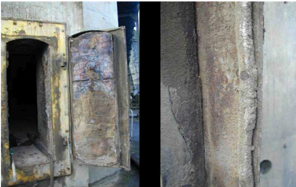
Rysunek 4.12 Uszczelnienie ze sznura azbestowego. Zdjęcie z prawej strony przedstawia zbliżenie na sznur
