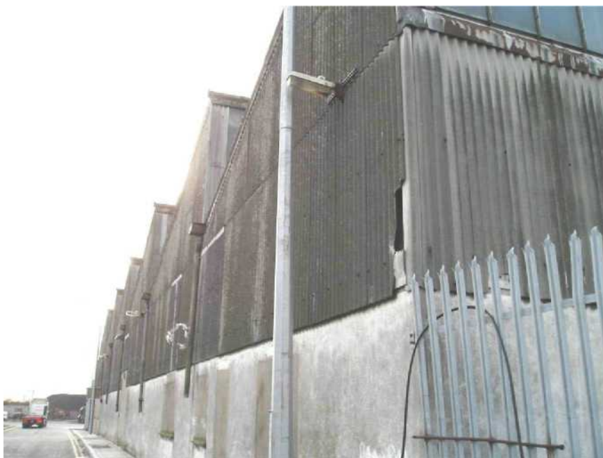
Rysunek 4.10 Okładzina azbestowa na ścianach fabryki
