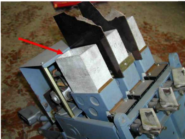
Rysunek 18.2 Elementy zawierające azbest w aparaturze rozdzielczej wysokiego napięcia
