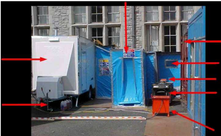
Rysunek 12.1 Wejście do osłony, przy czym strzałki wskazują od góry zgodnie ze wskazówkami zegara: zamknięcie worka, wizjer, pojemnik na odpady, przyrząd pomiaru podciśnienia, generator podciśnienia, układ zasilania, zapas środka do zwilżania i blok oczyszczania
